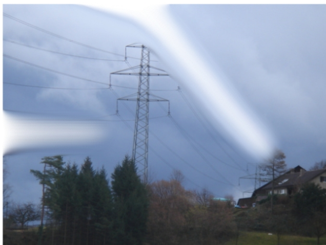
Sichtbare Korona (Tests mit Höchstspannung mit Leitung oberhalb Reckholdernfeldstrasse)
